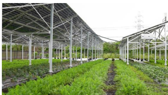
リエネソーラーファーム東松山太陽光発電所
